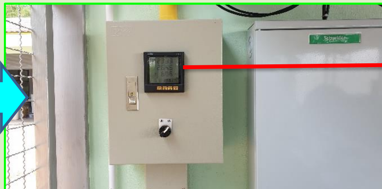
ตู้เมนไฟฟ้าจ่ายไฟเข้าระบบโรงเรือน
