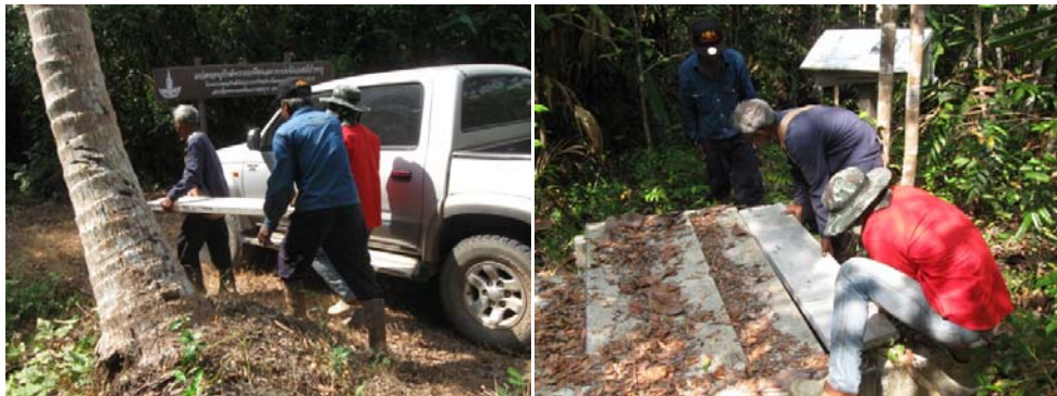
ภาพที่ 6 การติดตั้งแผ่นพื้นคอนกรีตเสริมเหล็กแบบสำเร็จรูปเพิ่มเติม
