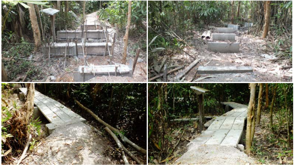
ภาพที่ 5 การซ่อมแซมโดยเปลี่ยนคานและพื้นทางเดินเป็นคอนกรีตเสริมเหล็ก
