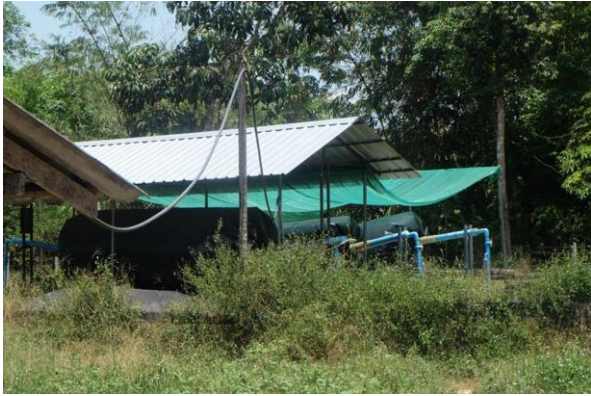
บ่อบำบัดน้ำเสีย
